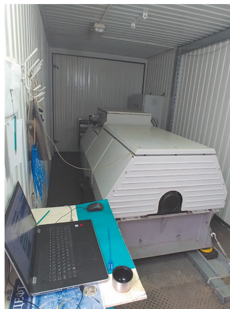
Рис. 1. Накопитель энергии НКЭ-3ГТ контейнерного исполнения
