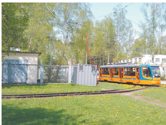
Рис. 2. Накопитель энергии НКЭ-3Г в контейнере подключен к КС вблизи ТП и линии движения трамваев. Коломна, 2020 г.
