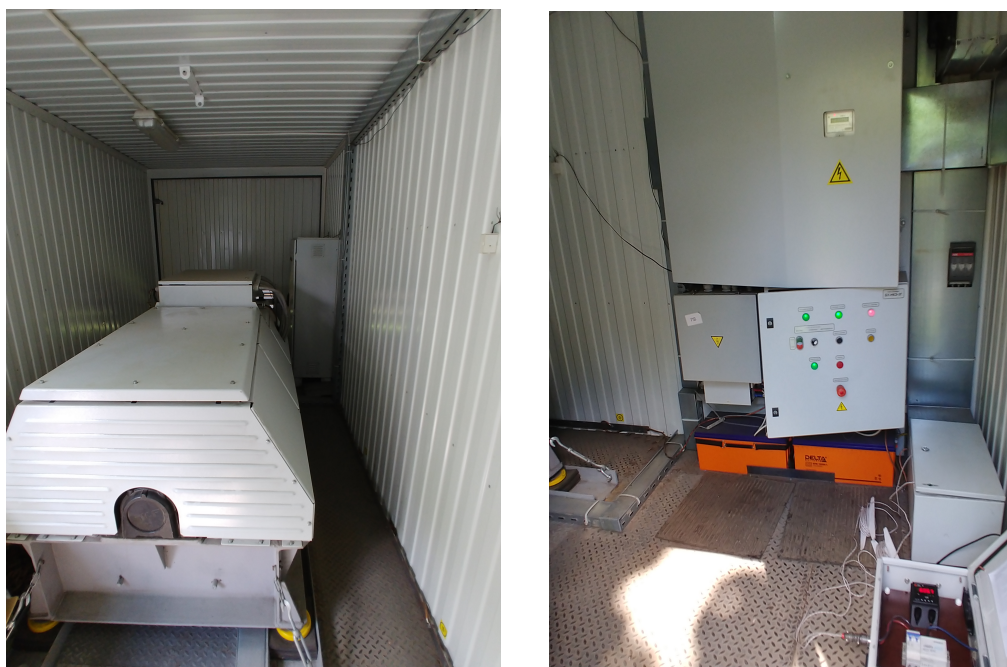
Рис. 2. Маховичный накопитель энергии НКЭ-3Г и его шкаф управления с двунаправленным счетчиком энергии СКВТ-Ф610
